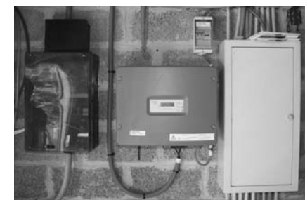
De gauche à droite : le compteur du réseau (qui tourne à l'envers !), l'onduleur (qui transforme le courant continu en courant alternatif), le compteur de production (qui calcule la quantité d'électricité produite) et le tableau de distribution de la maison.
